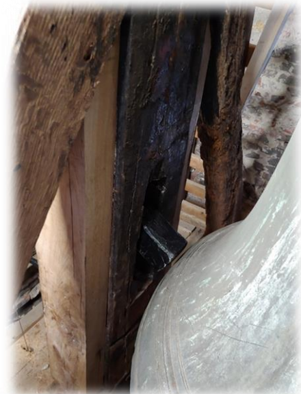
In de gerestaureerde klokkenstoel is een uitsparing gebleven zodat de slaghamer tegen de klok kan slaan..
